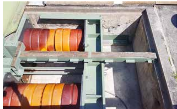
Stossschutzpuffer beim Untertor der Schleuse
