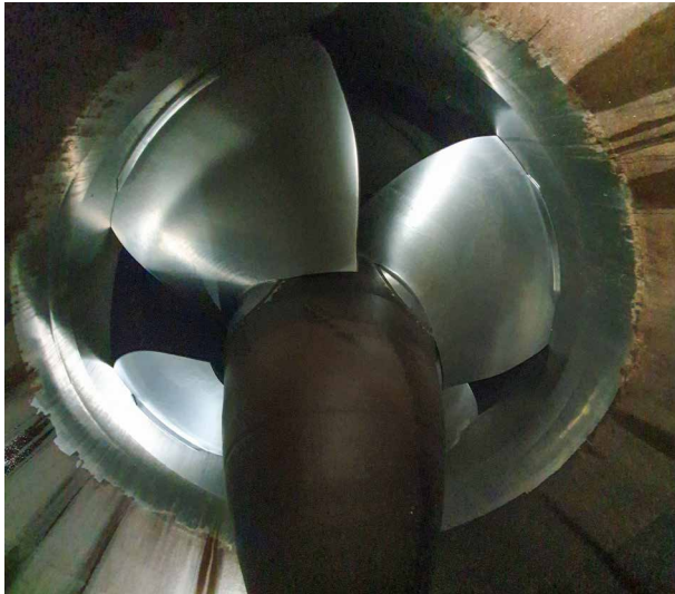
Trockengelegte Kaplanmaschine in Revision
