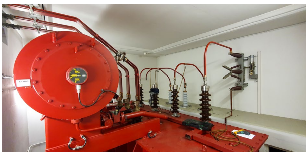
Defekte Transformator Durchführung
