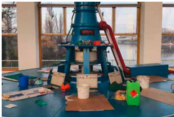
Maschinenrevision: Kontrolle und Reinigung des Schleifrings
