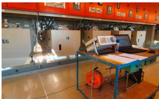
Inspektion und Funktionskontrolle 50 kV-Schaltanlage
