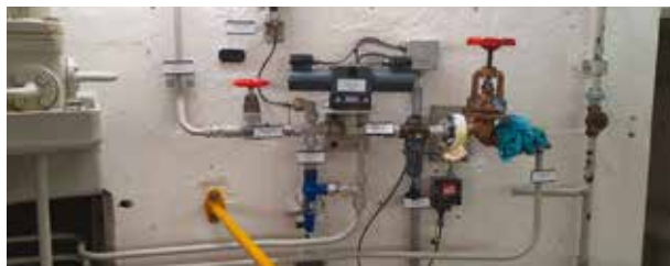
Armaturen und Ventile der Bremseinrichtung
