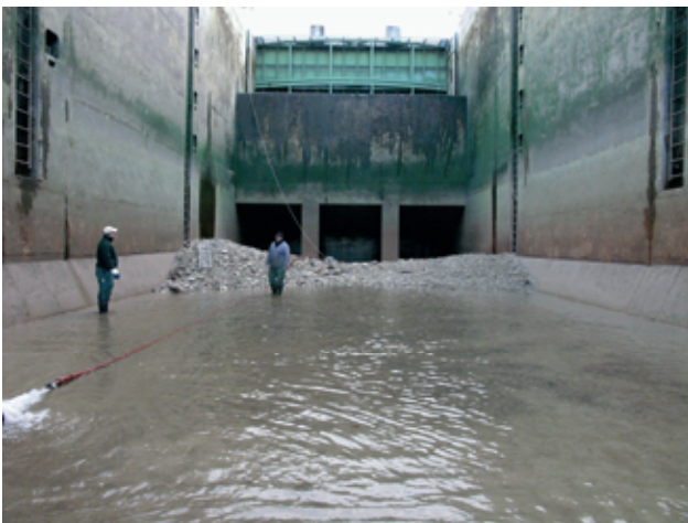
130 \text{ m}^3 angeschwemmtes Kies in Schleuse Nord
