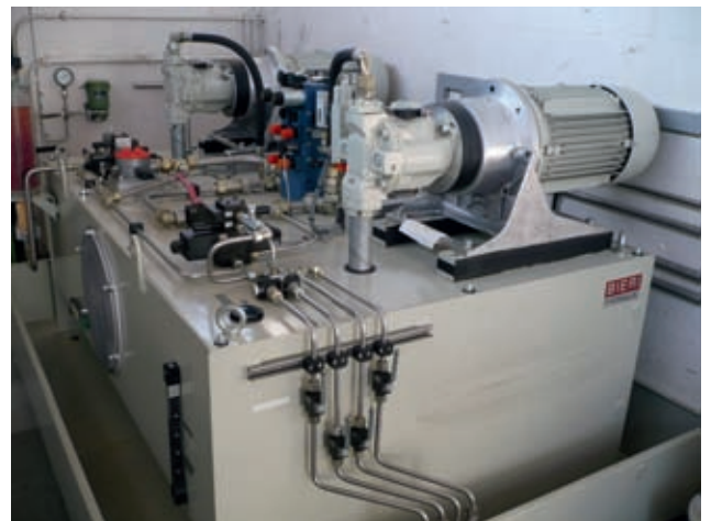
Hydraulikantrieb für Stemmtor Schleuse Süd
