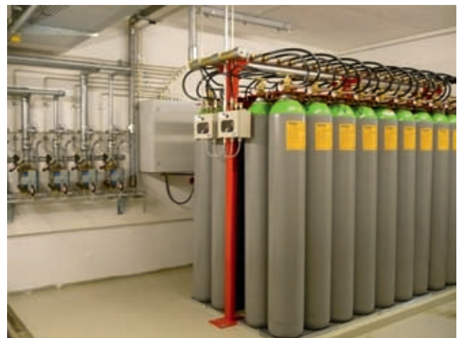
INERGEN Löschanlage für Generatoren / Trafos
