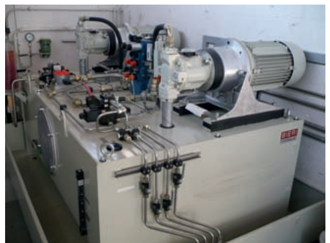
Hydraulikantrieb für Stemmtor Schleuse Süd
