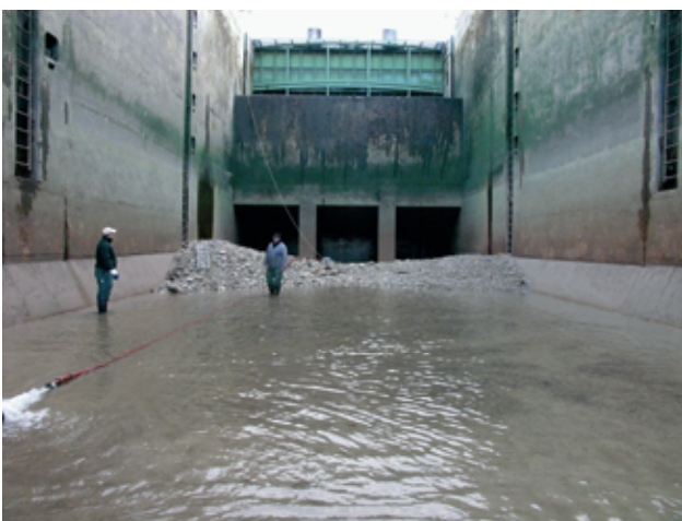
130 m 3 angeschwemmtes Kies in Schleuse Nord
